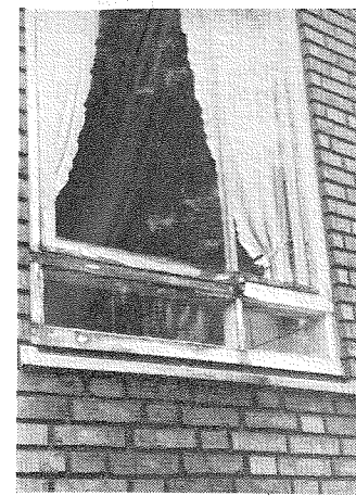
Billedet illustrerer kondensvandets ødelæggende virkning på vinduesmaling. Bemærk den mindre ødelæggelse på vinduets højre side, hvor rammen svinger indad, og hvor kondensvandet ikke kan samle sig i falden
